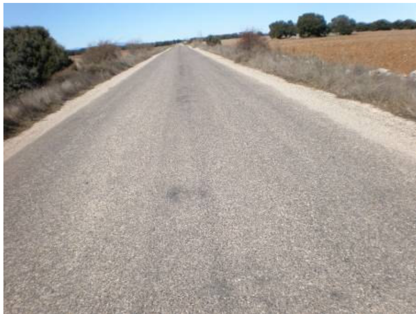
Ejemplo de doble tratamiento superficial ejecutado, tras un año de su puesta en servicio Carretera de acceso a la Presa de la Tajera (Guadalajara)
