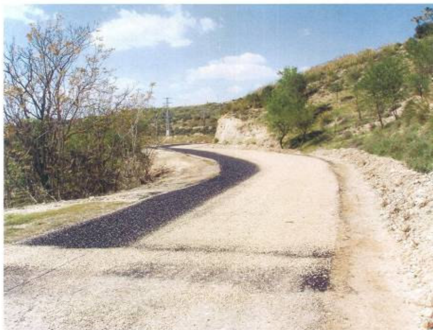
Ejemplo de tratamiento superficial en ejecución. A la izquierda se observa la zona donde se ha regado con emulsión pero aún no se ha extendido el árido. A la derecha se observa la zona donde ya se ha extendido el árido.
